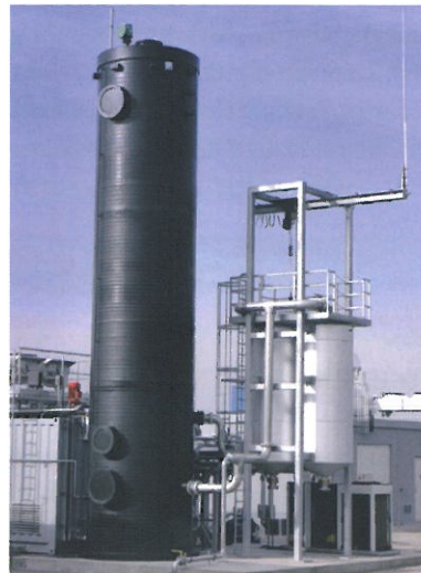
Biogasanlage mit Aminwäsche
